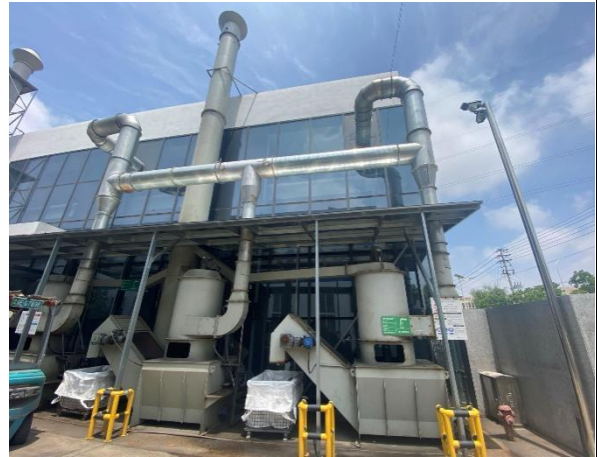
抛丸废气排放口
