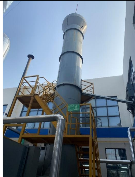
RTO 废气排放口
